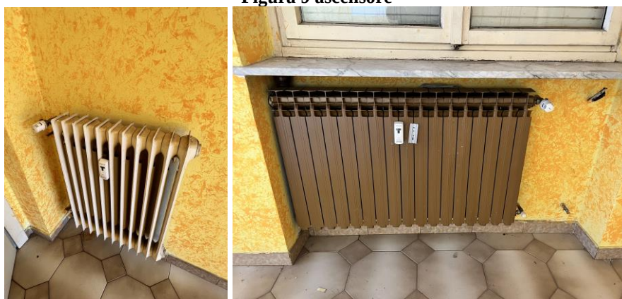
Figura 10 termosifoni con termo valvole
