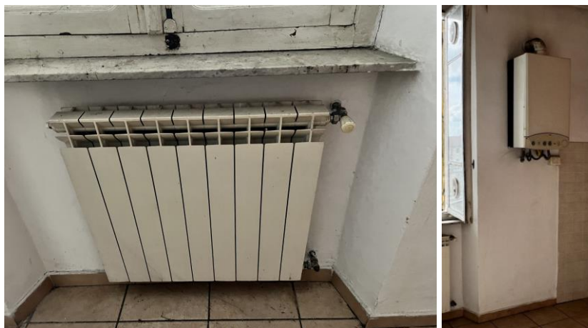
Dettaglio riscaldamento- Caldaietta
