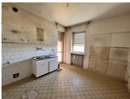
Figura 2 cucina con predisposizione caldaietta
