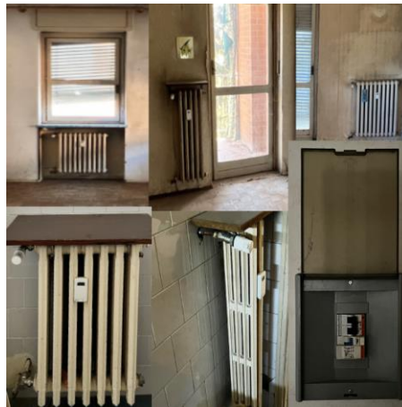
Figura 10 termosifoni con termovalvole e contatore
