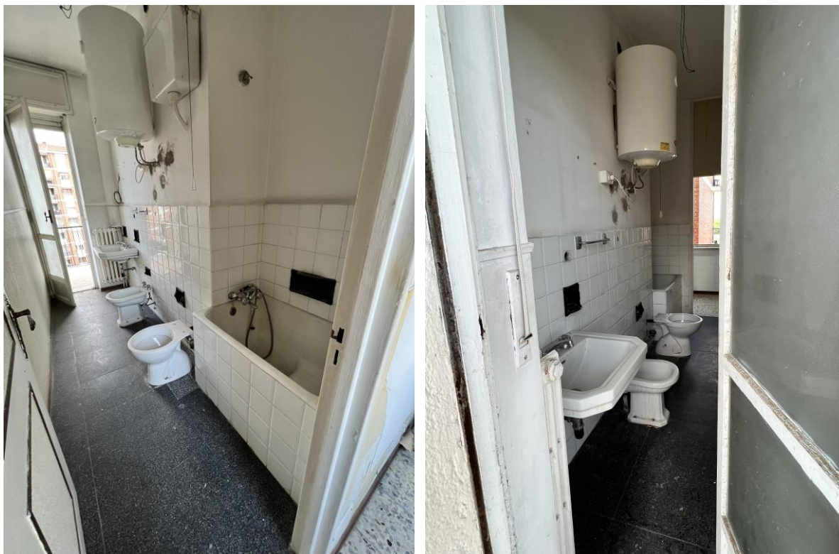
Figura 6 Bagno con boiler elettrico
