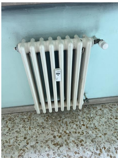
Termosifone con termovalvole
