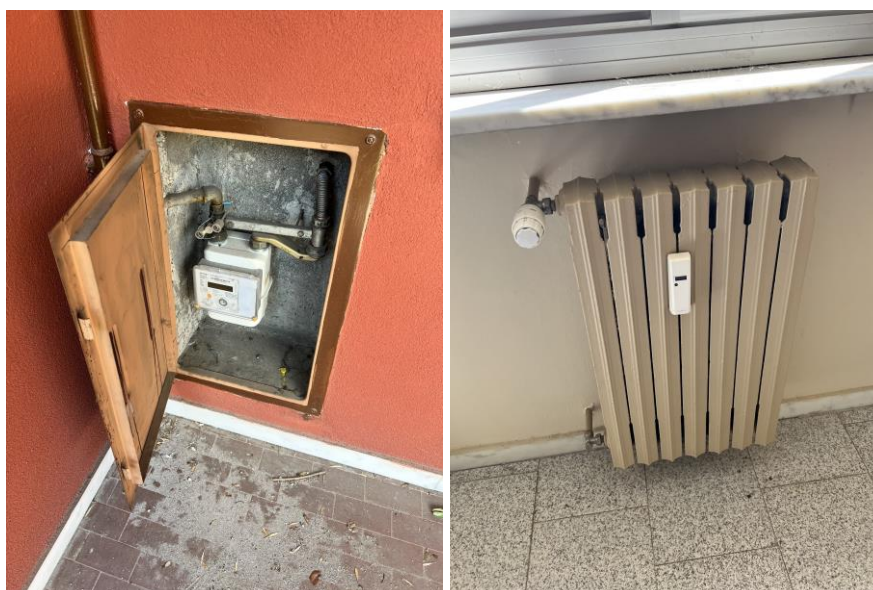
Figura 9 contatore gas in balcone, termosifoni con termo-valvole
